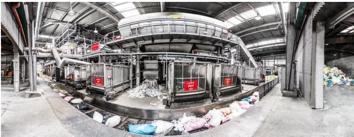
Hightech Sortieranlage für Kunststoffverpackungen in Graz, Fotorechte: Saubermacher
